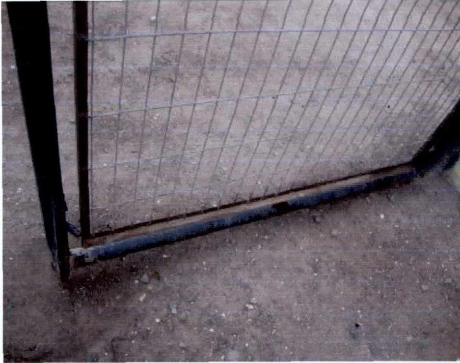
Fotografía 2: Perfiles metálicos con presencia de óxido.
