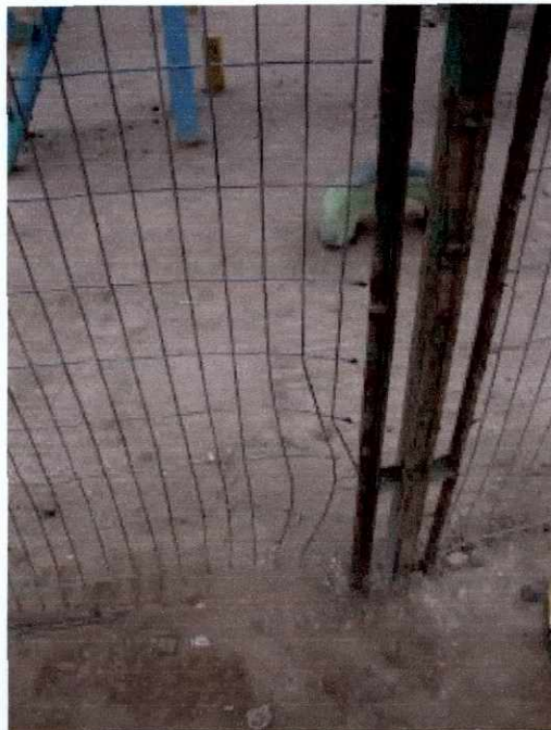
Fotografía 12: Malla acma desoldada.
