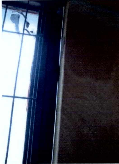
Fotografía 9: Puerta no cierra correctamente
