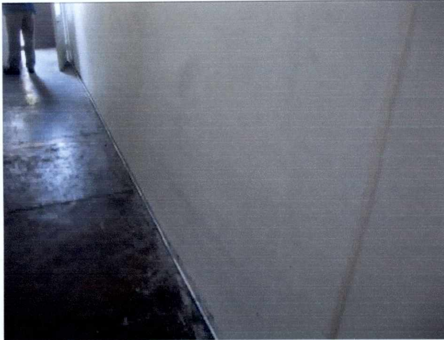
Fotografía 1: Muro no se encuentra totalmente liso
