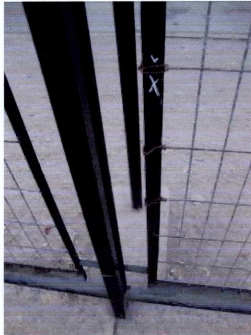
Fotografía 6: Malla acma desoldada y amarrada con alambres
