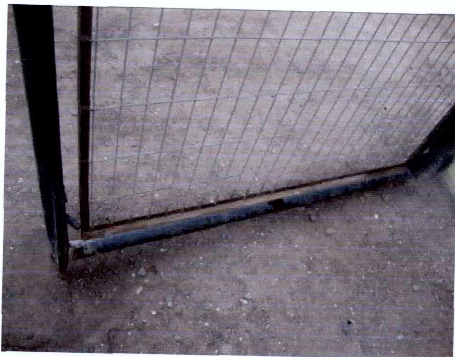
Fotografía 7: Perfiles corroídos y sin pintar
